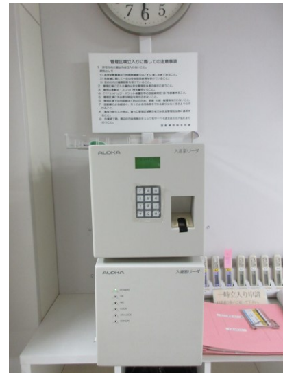
〔入退室管理システム〕 ALOKA CRD-1610D (出入口)
